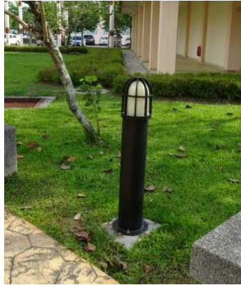
Lampu Bollard Sumber : JPBW
